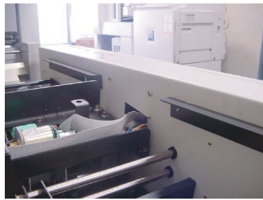
Fig. 47 注意すべき箇所 3
