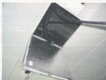
天井輻射パネル
