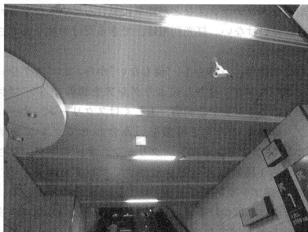
写真-1 減灯状況(都内の私鉄の駅) 合計41灯ある蛍光灯のうち点灯していたのは8灯だけ。 しかし床上1mの水平面照度は250~300lxだった。
